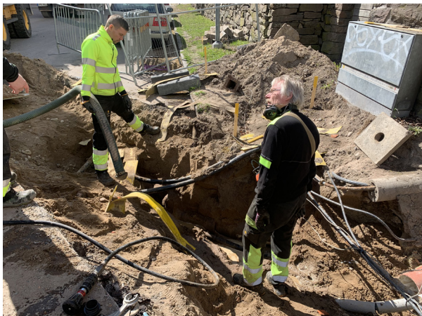
Vardagsproblem: ett trassel av ledningar i Östra Kyrkogatan. Foto: Ellinor Larsson, Värmlands Museum.
